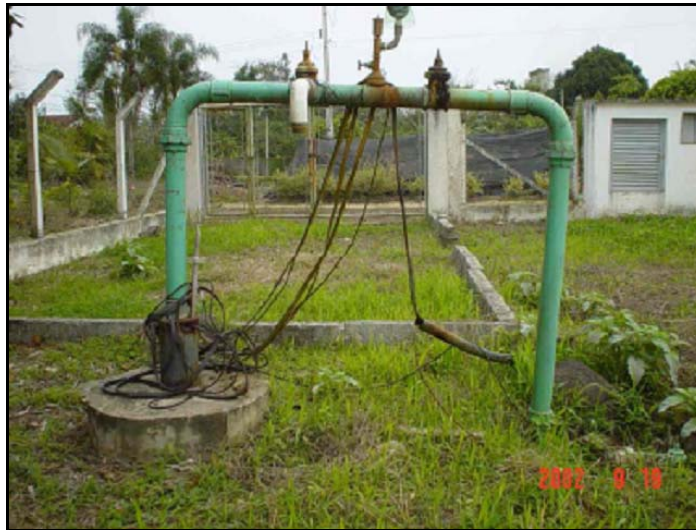
Figura 8.2 Captação em poço profundo, Bairro Conchal; Município de Miracatu. (Fonte: COTRIM, 2006).
